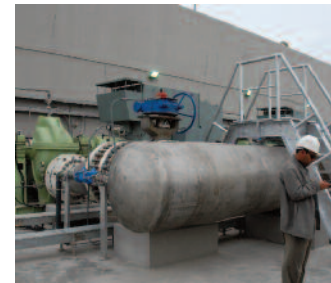
◀ Seawater desalination plant, El Hamma, Algiers
