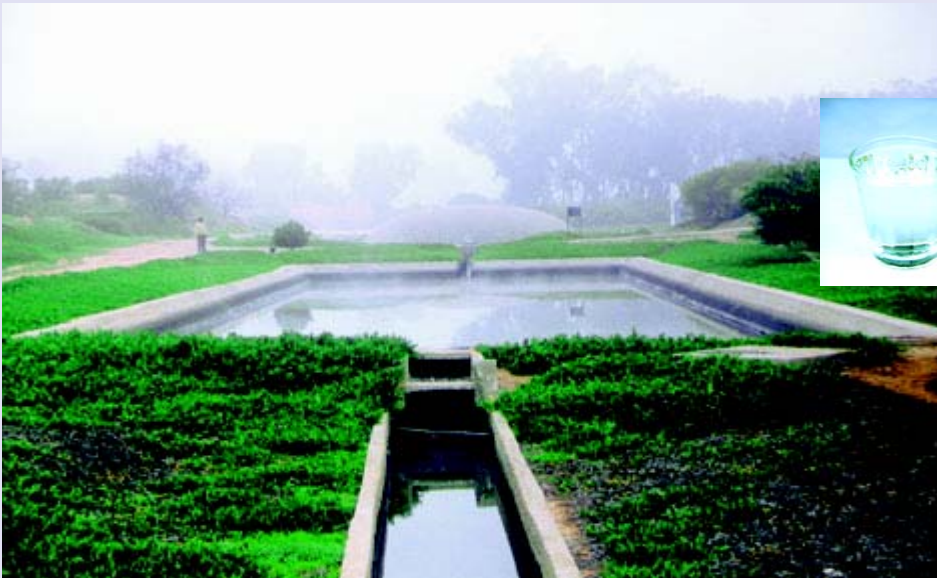
Décanteur anaérobie volume 1500m 3 , profondeur de 4m.
